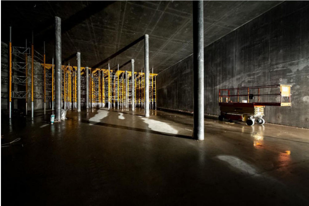
Trinkwasserbehälter © Berliner Wasserbetriebe/Benjamin Pritzkuleit
