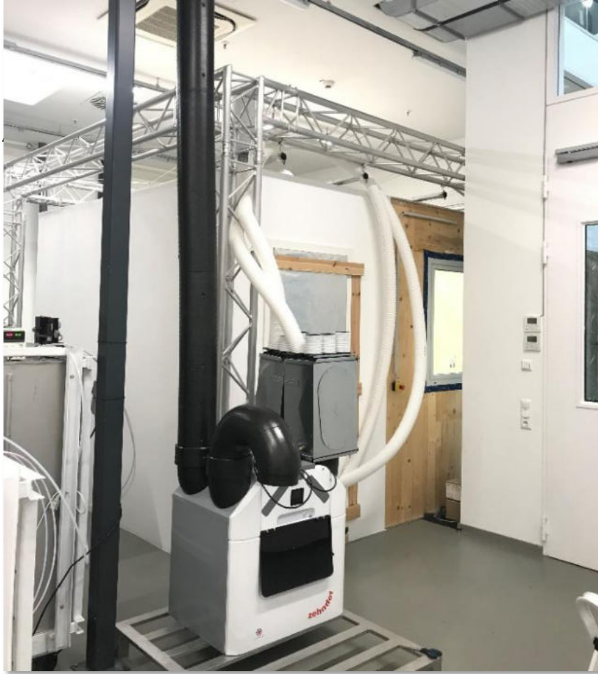
Anschluss Lüftungssystem an Referenzraum
