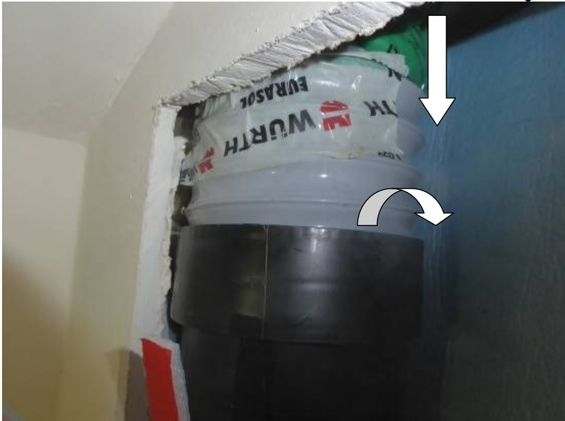
Foto 4: Theaternebel tritt aus dem Entlüfterrohr aus
