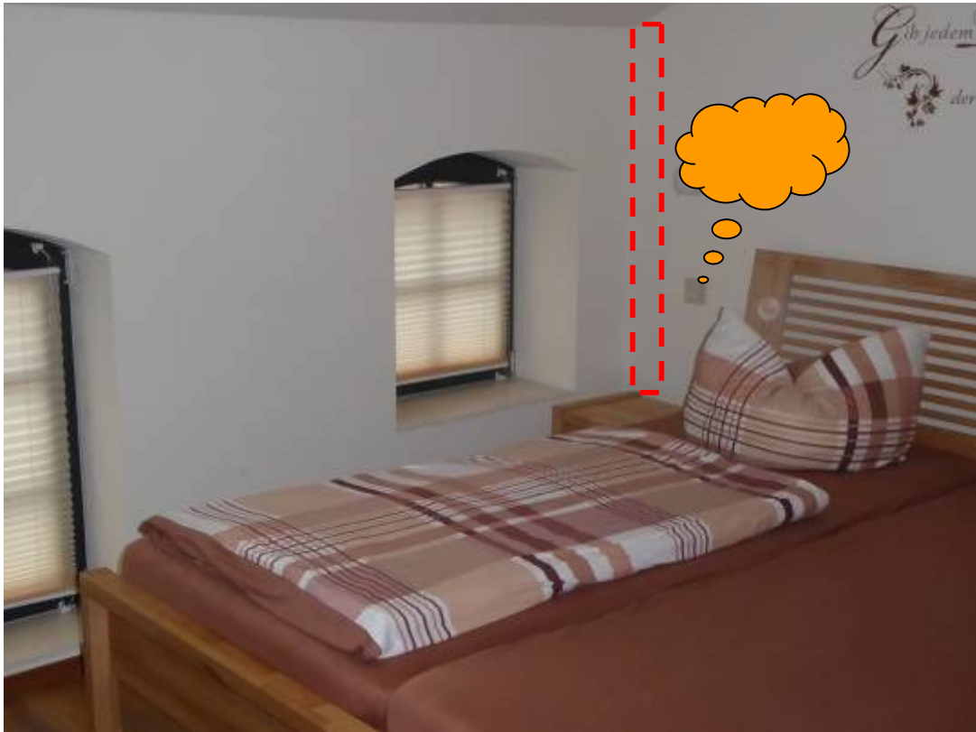
Foto 1: geruchsbelastetes Hotelzimmer im Dachgeschoss; Blick auf Außenwand und Innenwand (rechts) mit Verlauf des Entlüftungsrohres für den Fettabscheider (rot markiert)
