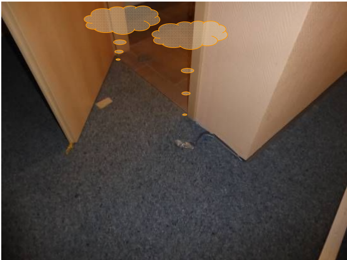
Foto 5: Hotelzimmer; Geruch tritt aus den Fußbodenrandfugen und den unteren Zargenkanten aus
