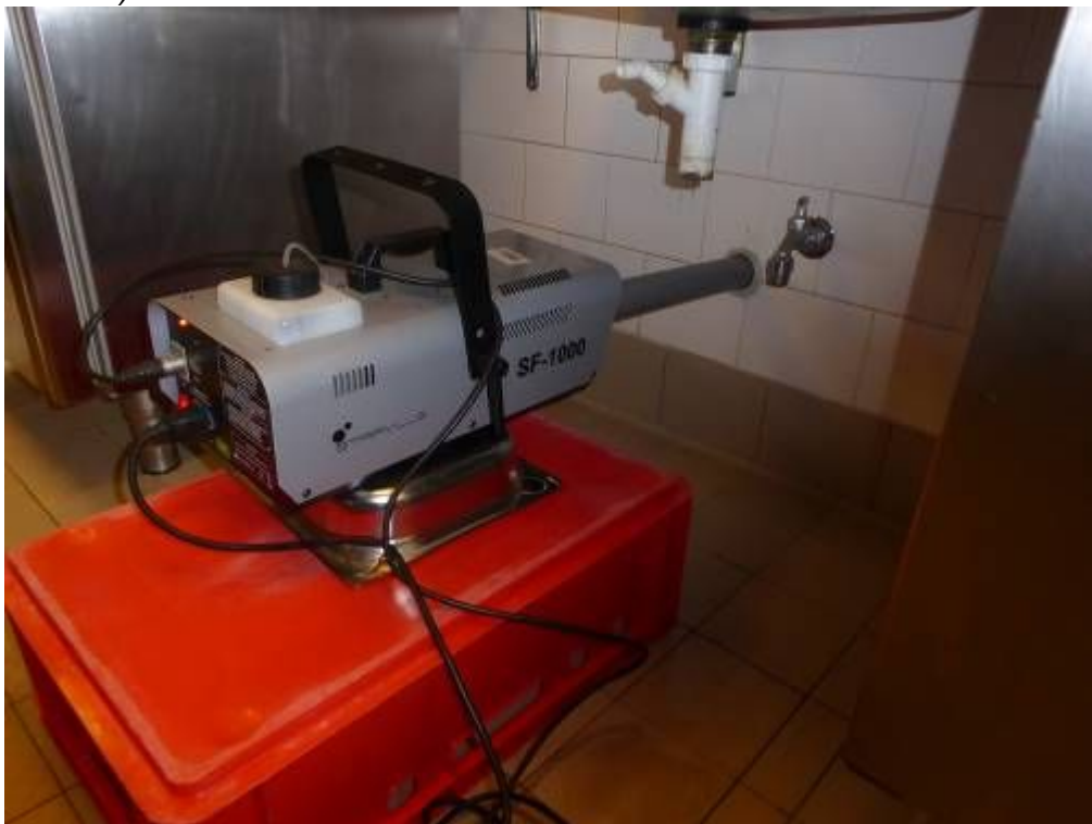
Foto 2: Küche, EG; Theaternebel wird ins Abwassersystem eingeleitet
